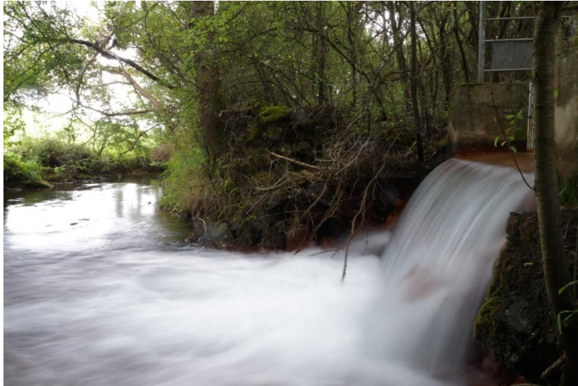
Figure 12 - Galerie de débordement du réservoir centre à Mancieulles, ancienne mine de fer
