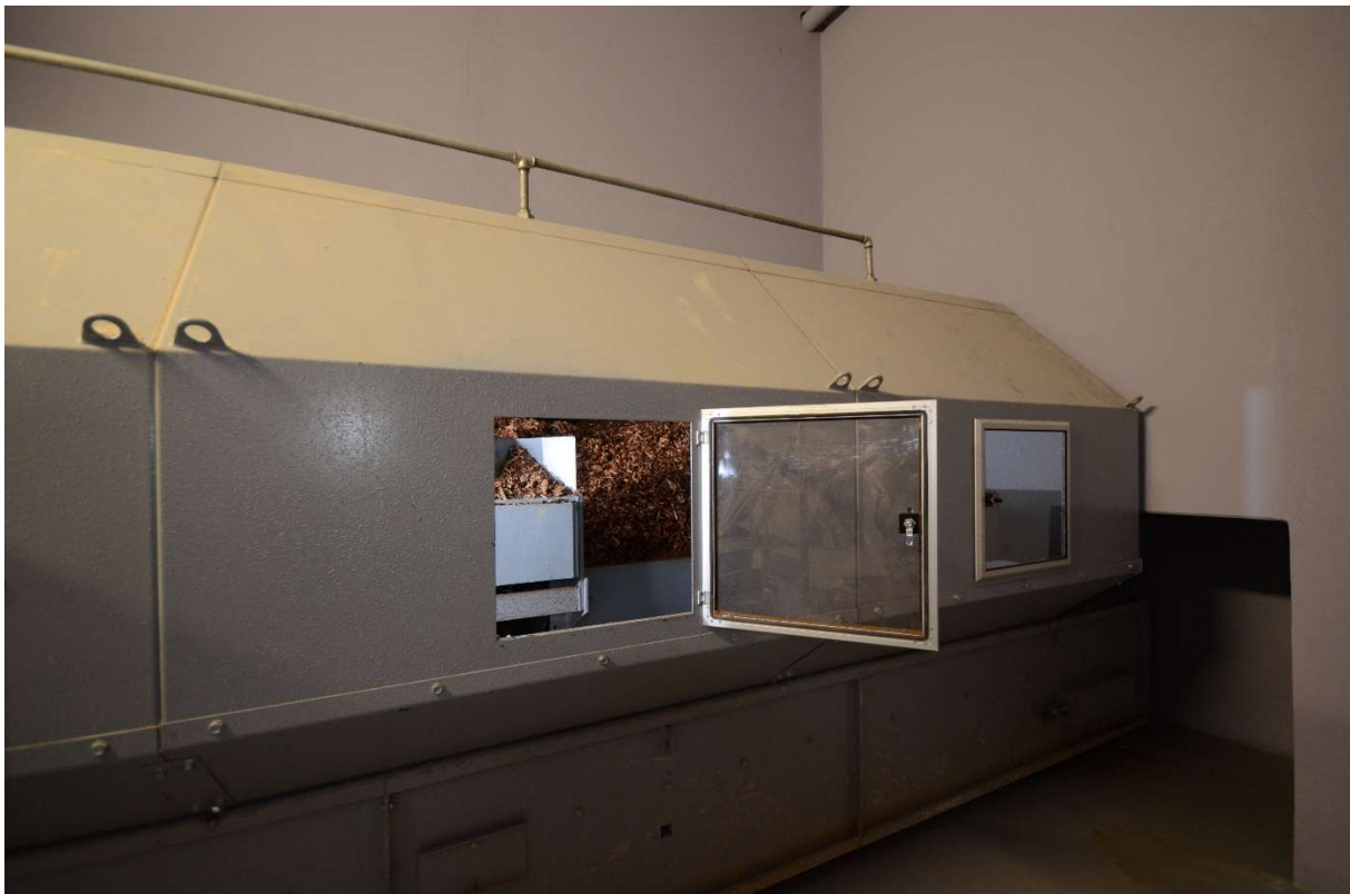
Chaufferie bois du lycée du Haut-Barr à Saverne.
