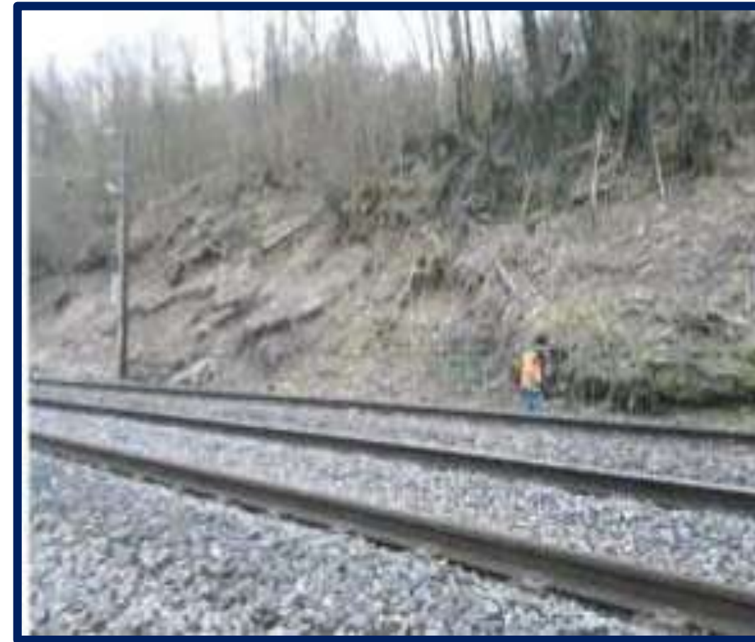
Glissement de terrain
