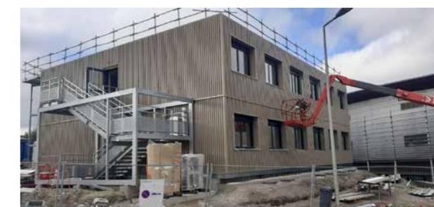
Travaux d'extension de l'internat du CHU de Reims (51) — Livraison prévue en décembre 2024
